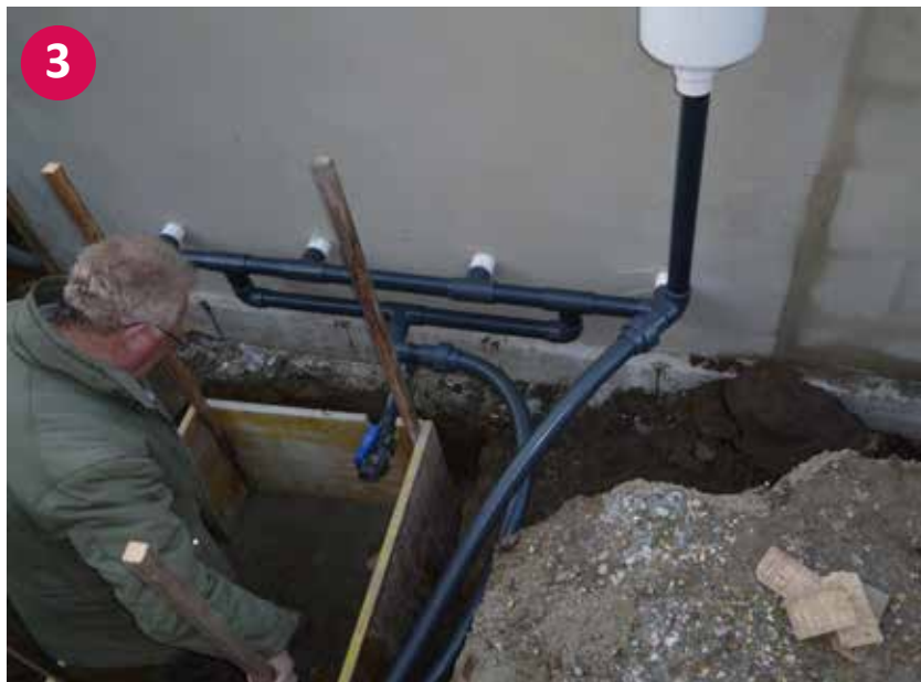
▲ Verrohrung von Düsen, Skimmer und Bodenablauf
