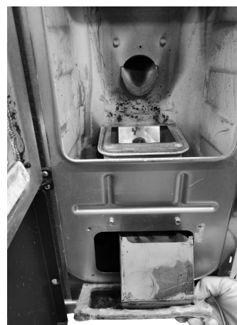
Fig. 73 - Den Inspektionsstopfen entfernen
